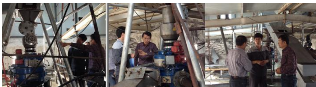
图 3 天然生物质材料清洁制浆试制线现场
